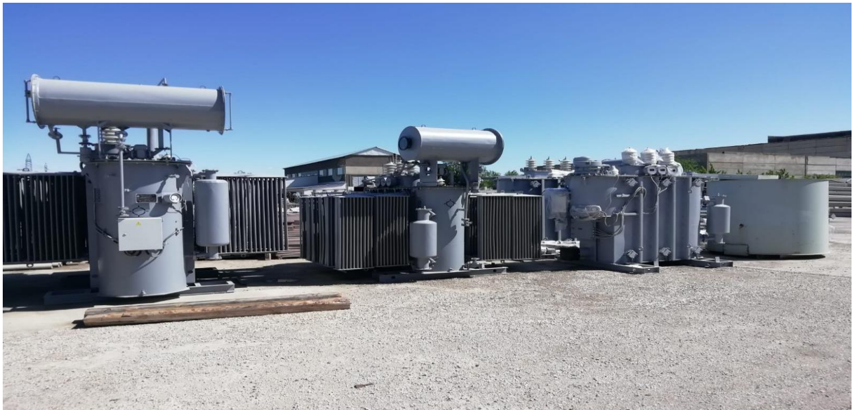
Силовые трансформаторы 35/10 кВ типа ТМН 4000 и 6300 кВА
