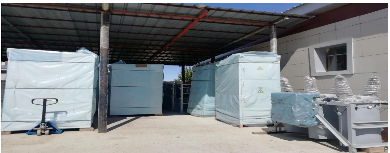
Ячейки КРН-4 и вакуумный выключатель 35 кВ
